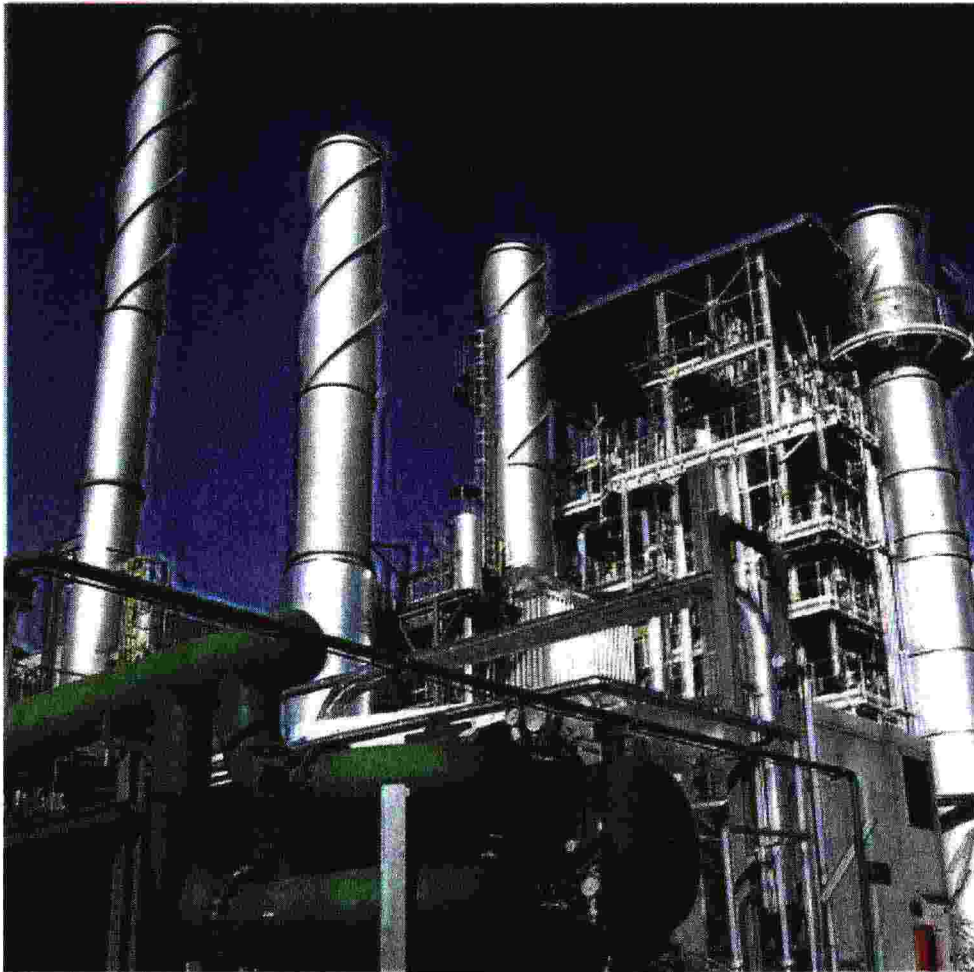
Il cuore energetico di Malpensa. La centrale di Malpensa (attiva dal 25 ottobre 1998) produce energia elettrica, calore e acqua refrigerata: parte dell'energia elettrica è ceduta all'esterno tramite la rete nazionale
