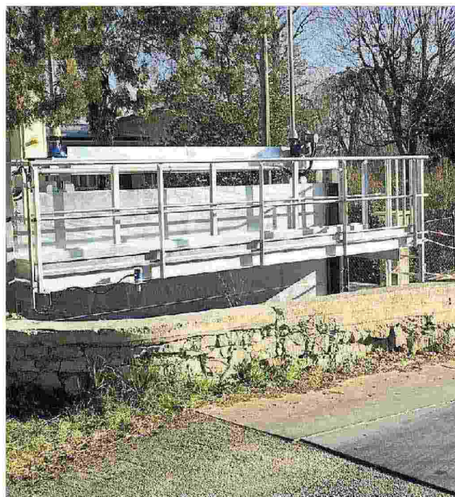
La paratia installata sulla roggia per bloccare le acque di reflusso dell'Isonzo
