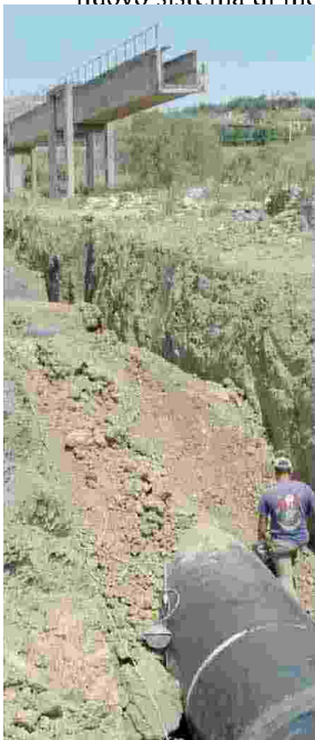
VERRANNO RIPARATE LE CONDOTTE 13 E 14
