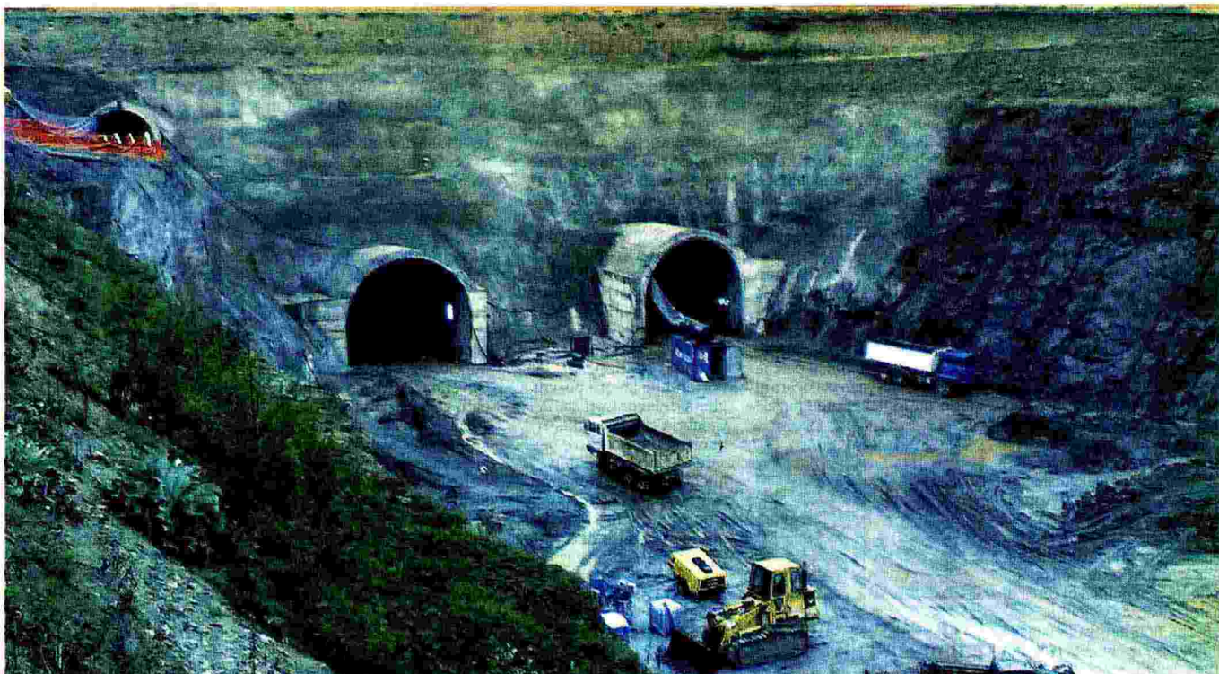
Incompiute calabresi. Finanziata dalla Cassa del Mezzogiorno nel lontano '83 con 500 miliardi di vecchie lire, la diga sul Melito (nel Catanzarese) non è mai stata ultimata
