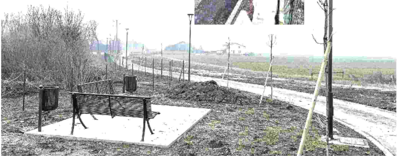
CANTIERE QUASI ULTIMATO La ciclabile dal centro città a Sarzano è pressoché pronta: lampioni, alberi e panchine sono stati già messi e l'apertura è imminente
