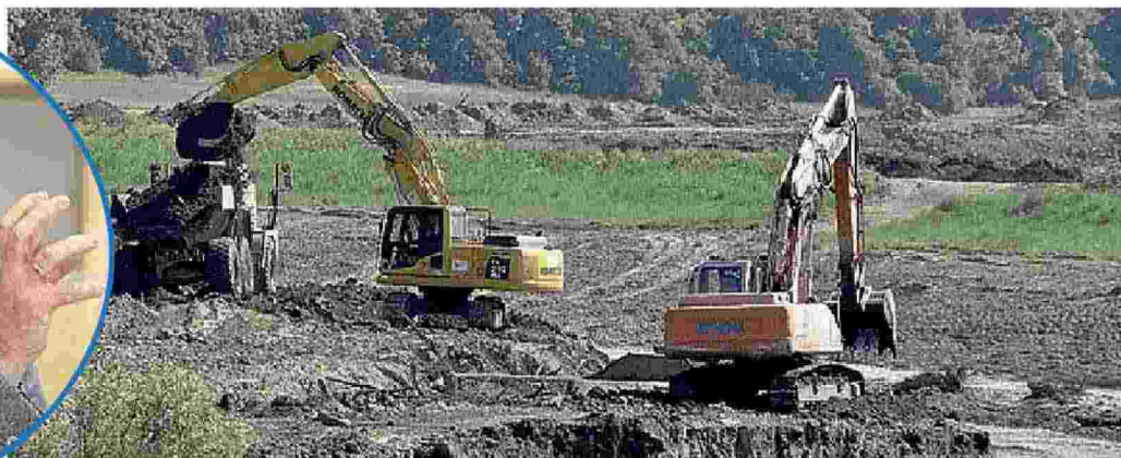
Marco Bottino, presidente del Consorzio di bonifica e ruspe al lavoro per la messa in sicurezza degli argini
