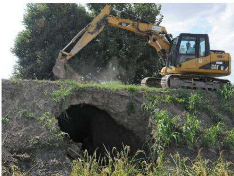
L'enorme tunnel provocato dal cedimento del terreno a causa delle nutrie a Vangadizza, lungo il Bussè
