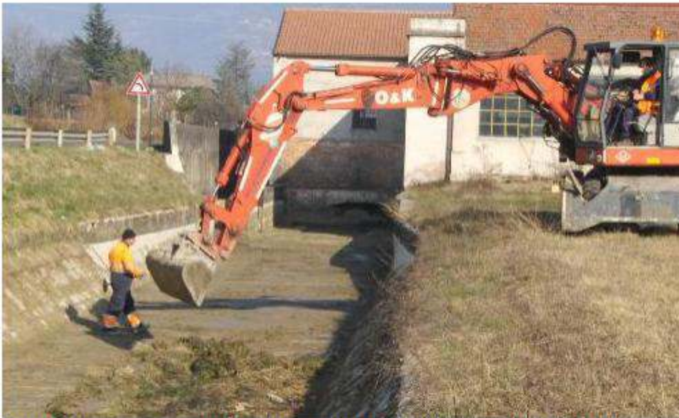
Mezzi del consorzio di bonifica al lavoro per ripulire gli alvei dei corsi d'acqua contro le alluvioni
