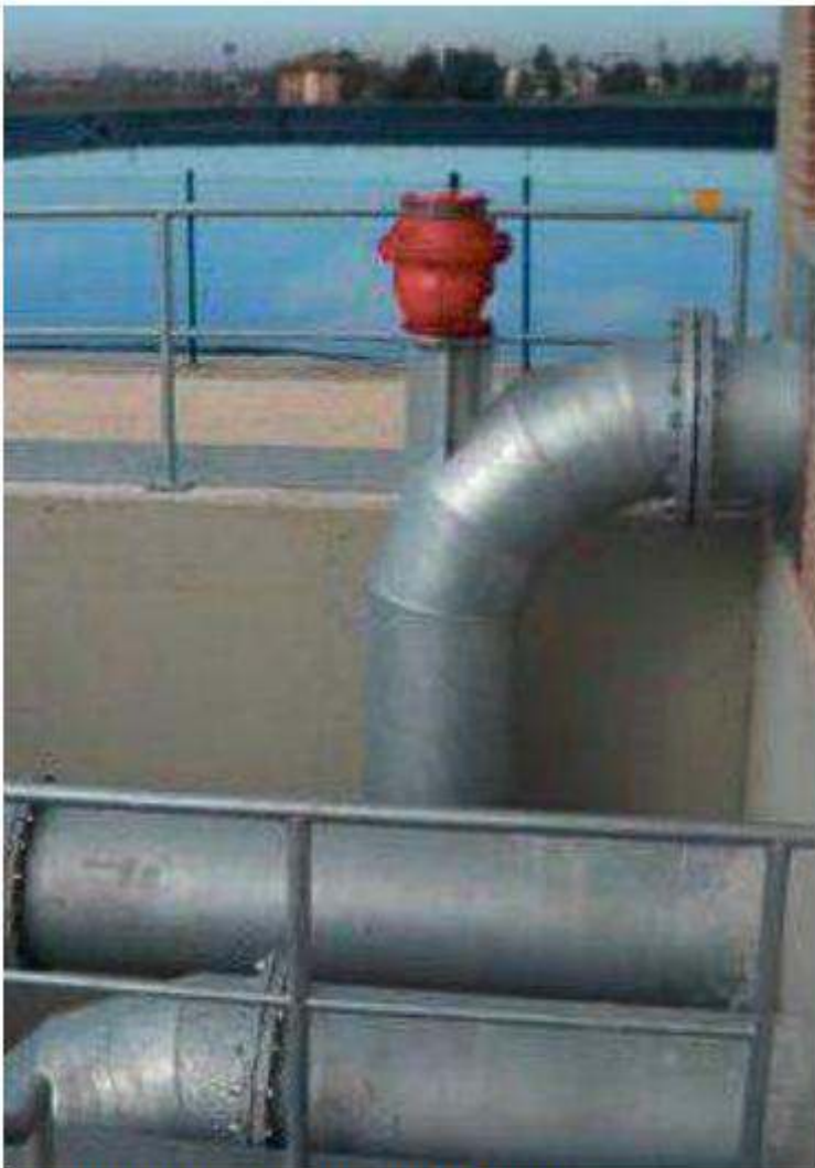
Una pompa irrigua del consorzio di bonifica Brenta
