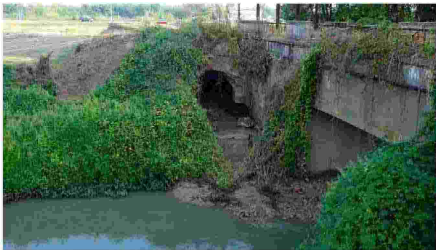
La frana che si è verificata a lato del canale artificiale del Navarolo
