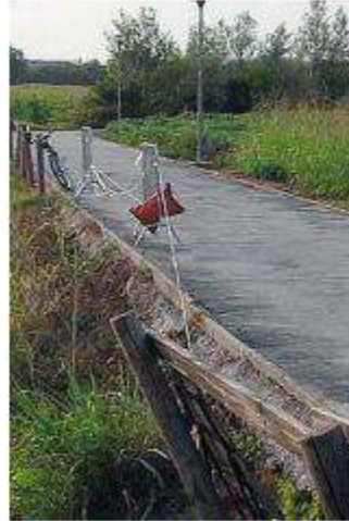
Il tratto di protezione crollato
