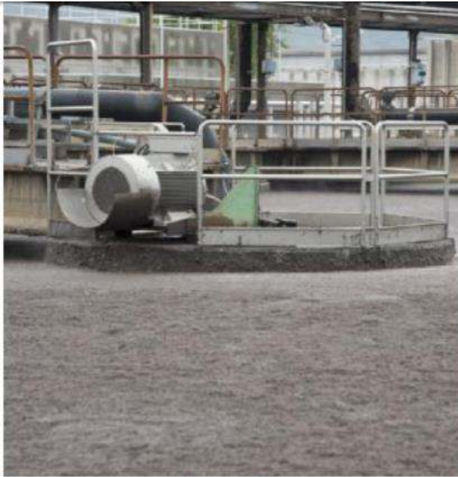
L'impianto di trattamento di Acque del Chiampo. ARCHIVIO
