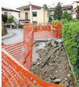
Un cantiere rimasto aperto
