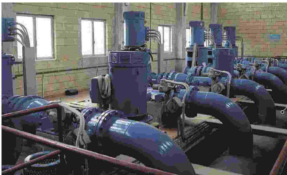
Una delle maggiori stazioni del Consorzio a Piegale di Terracina, sotto i canali
