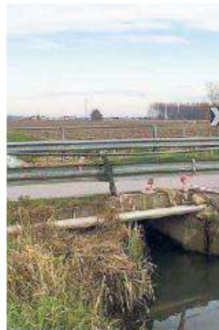
Il ponticello malmesso
