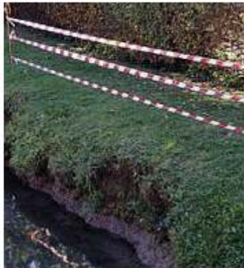
Il tratto crollato dell'argine
