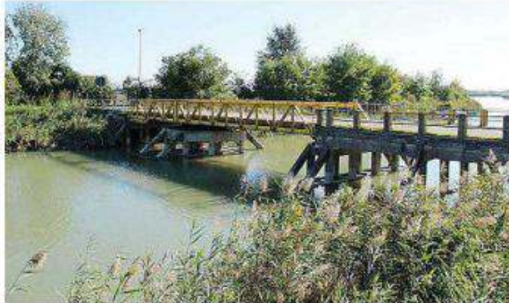
Il ponte girevole di Fossà è chiuso ormai da tre mesi (foto Tommasella)
