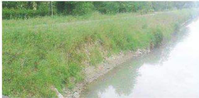
Crolli delle rive lungo il canale Serraglio
