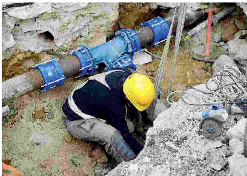
Sono necessari lavori di riammodernamento delle tubature idriche
