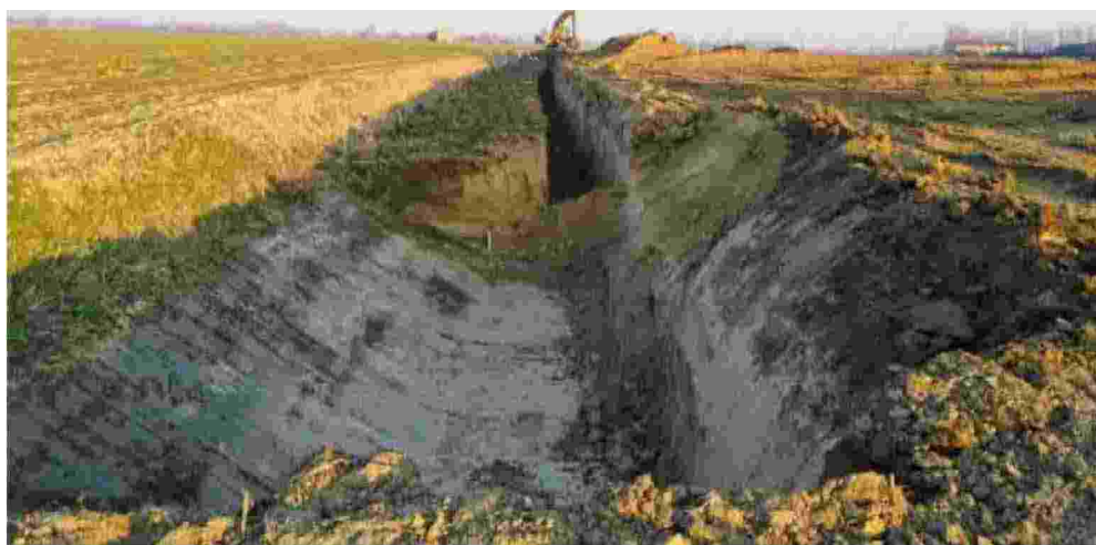
Il cantiere aperto dal Consorzio di bonifica veronese per mettere in sicurezza la frazione di Bionde
