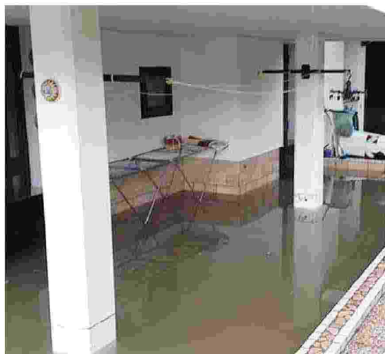
L'acqua è entrata nella casa e nel garage di diverse abitazioni nella frazione di Cesarolo
