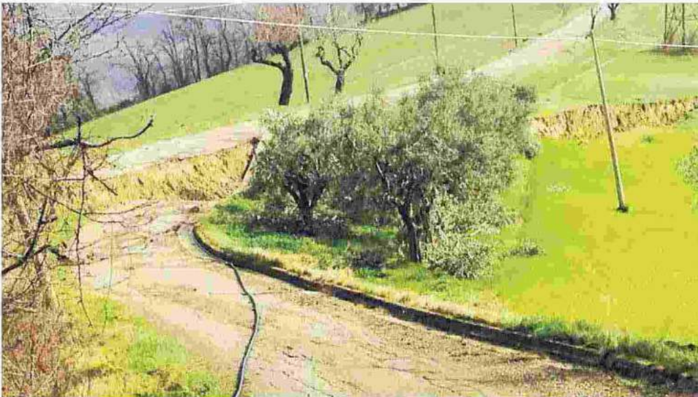
Colletrotta-Pagliari, una delle 19 contrade danneggiate dal dissesto ideogeologico avvenuto a marzo 2015
