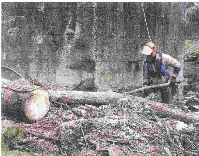
Un addetto del consorzio Dunas rimuove uno dei tronchi sotto il ponte di via Cadorna
