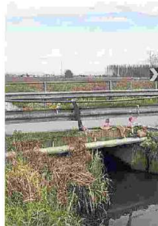
Il ponticello malmesso
