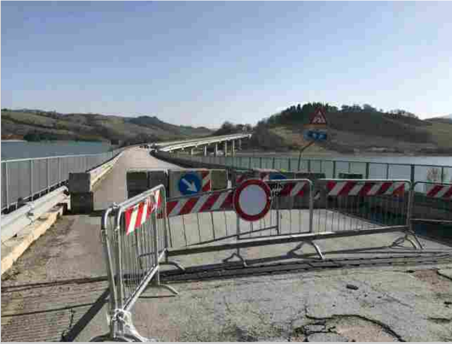
Il viadotto di Castreccioni chiuso al traffico
