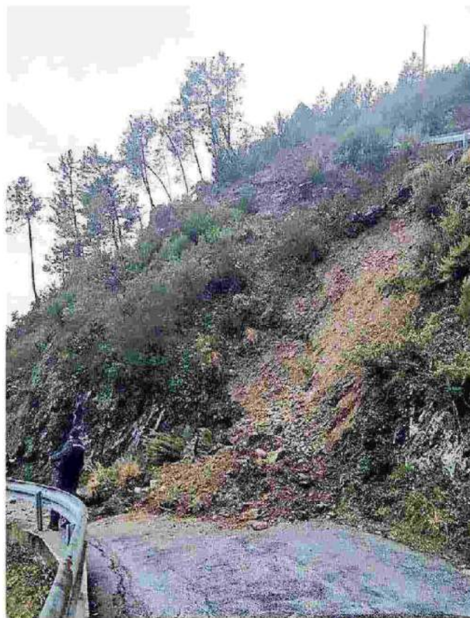
La frana sulla strada di Strinato a Strettoia
