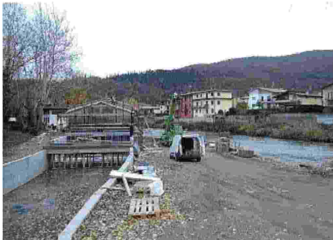
Le opere idrauliche per la centralina idroelettrica di Gavardo
