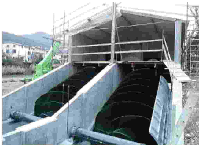
Un particolare degli impianti di generazione
