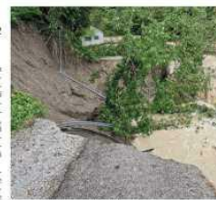
Un esempio dei danni causati dall'alluvione di maggio
